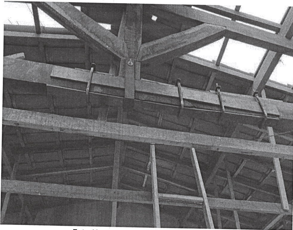
Foto 19- Revisão de esquadria de madeira
